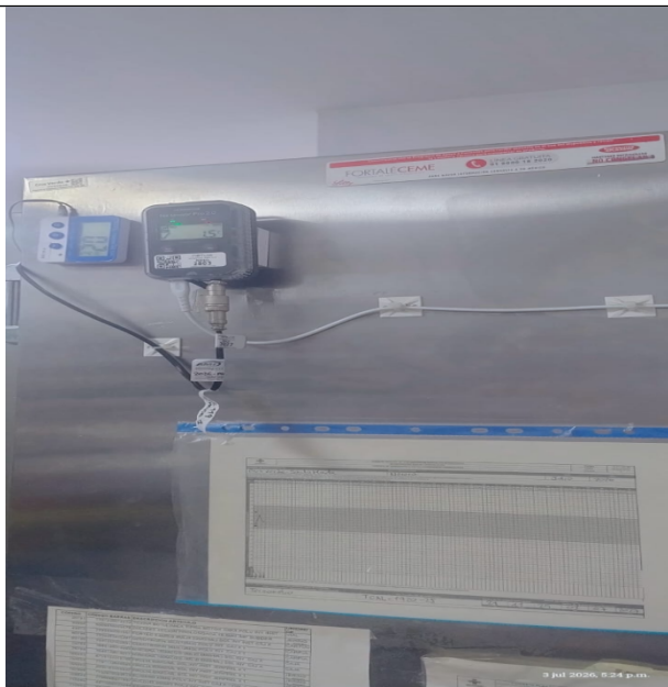
Sistema de emergencia (Netux) por temperatura
